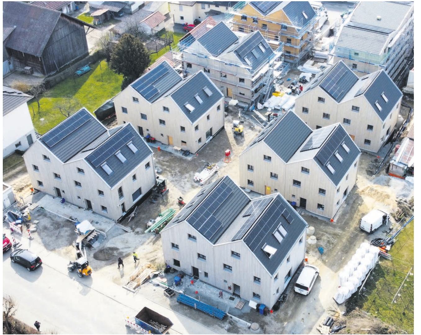
Modellprojekt Engagierte Bürger in Allensbach am Bodensee haben »SoLAR« initiiert, um zu zeigen, dass man mit der flexiblen Steuerung von elektrischen Geräten »virtuelle Batterien« erzeugen kann, um das Speicherproblem der Energiewende zu lösen. Bild: © Easy Smart Grid
